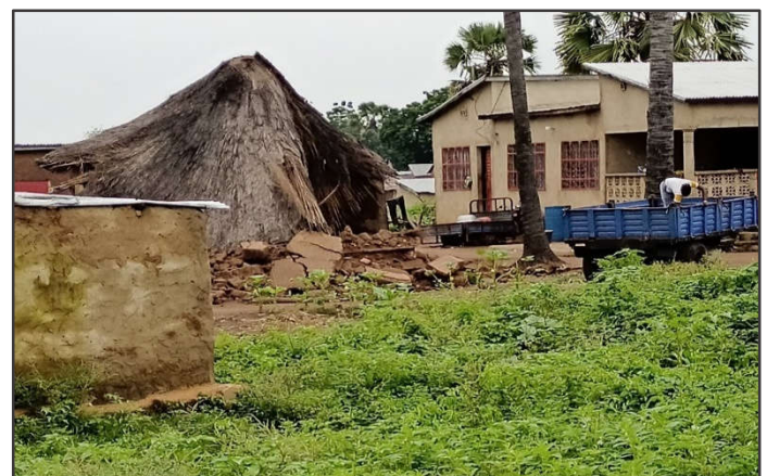
Photo 2 : Une maison écroulée suite à une violente pluie Prise de vue : Ouassa, septembre 2021
